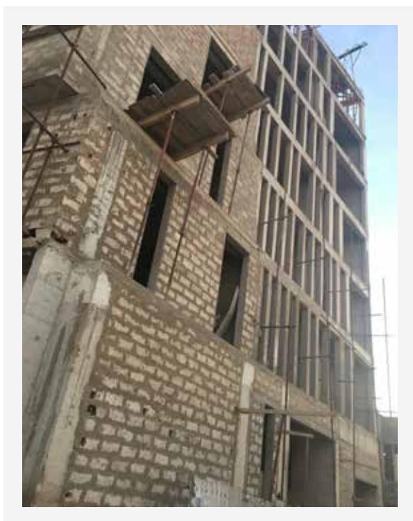
Image 14 : Manque de communication et de sensibilisation – projet de construction non conforme. Source : CRPP (2019).
